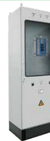
Быстродействующий автоматический ввод резерва 6 (10) кВ
